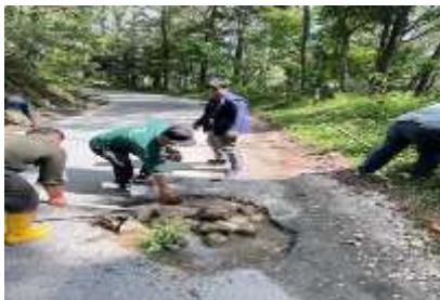
Gambar 1. Permukaan aspal mengelupas dan erosi bahu jalan di Desa Silalahi I
